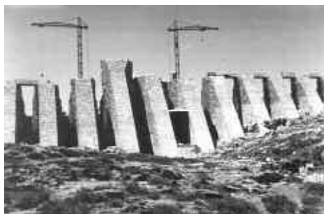
Obras de construcción de la presa de Vega de Tera. Década de 1950
